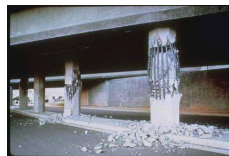
Flambement d'un pont © Esprit Génie Civil
